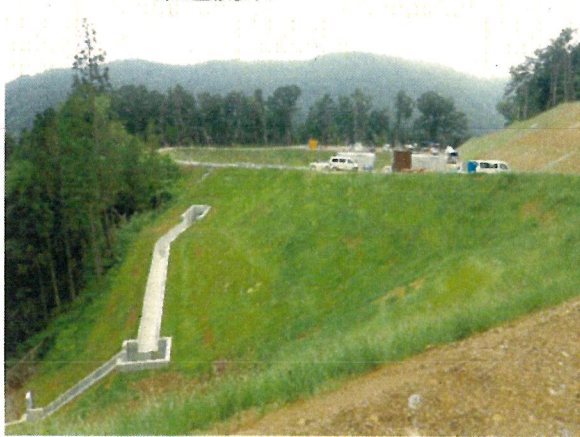
3号調整池（オリフィスからの流出なし）
