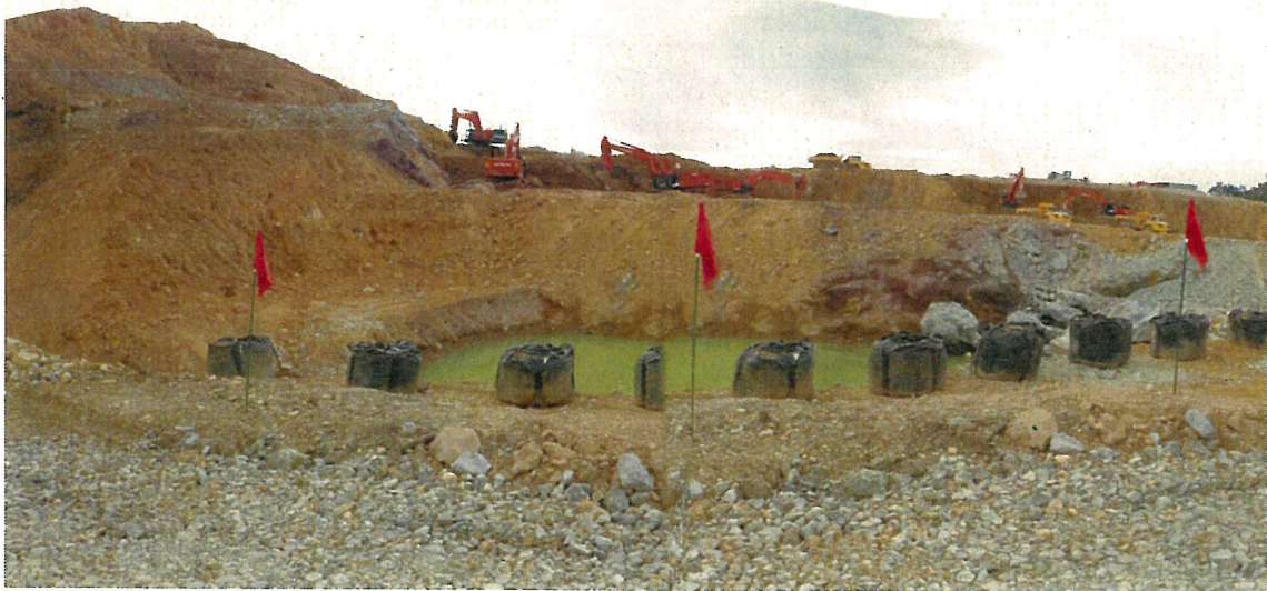
3号池上流沈砂池 帯水状況を確認
